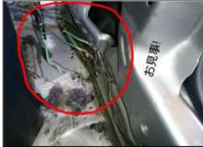
断線箇所は合計14本 場所によっては手が入らない箇所 も思わず笑いが出た( ^ ▽ ^ )
